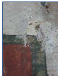
Fig. 13 et 14 - Bouchages fissurés des assemblages de la cuve ; bouchage en cours de dégagement © Amélie Méthivier
