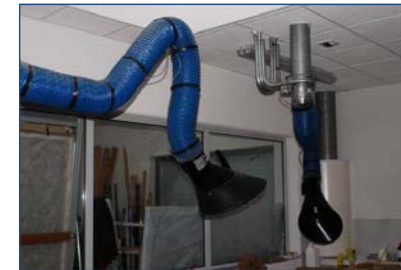
Fig. 4 - Extracteurs à vapeurs de solvants à bras articulés (atelier traitement) ; au fond, module d'arrivée d'air traité © CG66/CCRP - Marc Michalczak
