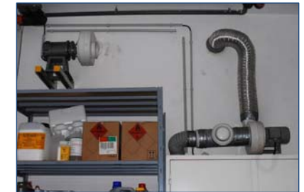
Fig. 5 - Système d'extraction du local de stockage des produits toxiques ; à gauche, extracteur pour le local, et à droite, extracteur de l'armoire à solvants © CG66/CCRP - Marc Michalczak
