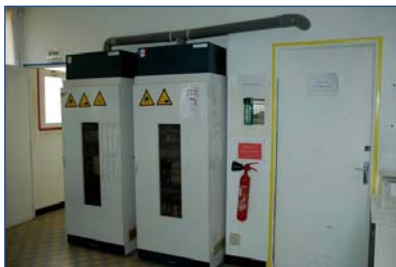
Fig. 3 – Les anciennes armoires à produits, non étanches et mal ventilées n'assuraient pas de protection en cas d'incendie © Jacques Rebière
