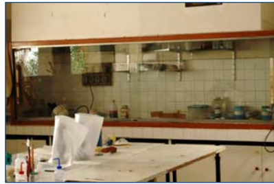
Fig. 1 – L'ancienne sorbonne s'ouvrait latéralement (noter le scotch qui tient la poignée sur le verre à gauche et au centre de la photo). L'aspiration (très bruyante) ne se réglant pas, des risques de casse de la vitre rendait cet équipement inutilisable
